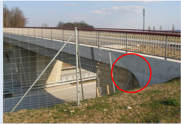
Negatives Beispiel : falscher Anschluss unter das Brückenbauwerk bewegt die Fledermäuse dazu, die Strasse zu überfliegen
