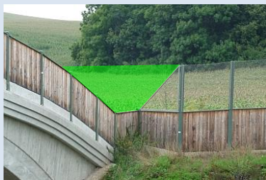
Schliessen von Lücken zwischen Zaun/Blendschutz notwendig
