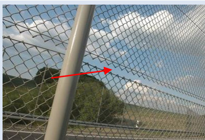
Les brèches dans la clôture doivent être obturées
