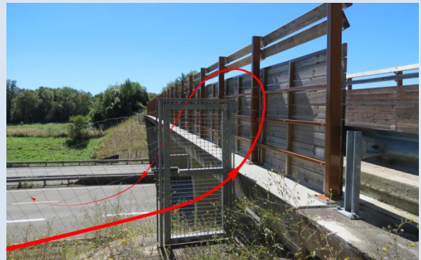
Exemple négatif : risque élevé de survol de l'infrastructure routière du fait du raccordement de la clôture en retrait de l'entrée de l'ouvrage
