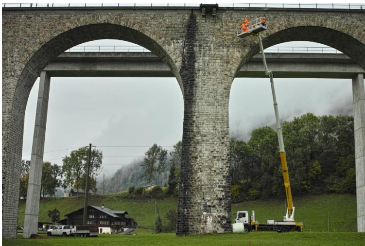
Figure 16: Prise en compte des chauves-souris lors de l'inspection d'un vieux pont en pierre.
