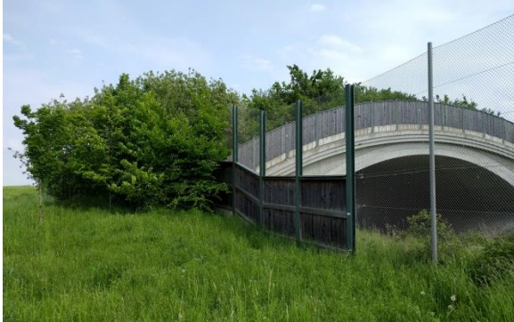
Exemple positif : raccordement adéquat de la clôture au niveau de l'écran latéral opaque ; une haie basse sert de structure guide sur l'ouvrage
