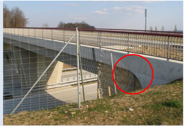
Exemple négatif : mauvaise insertion sous le tablier de l'ouvrage créant un point bas incitant les chauves-souris à survoler la route
